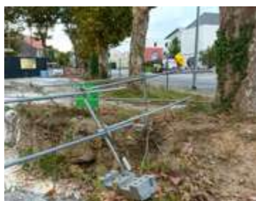
Un chantier particulièrement mal tenu, sans aucune protection des arbres contre les chocs, le tassement ou la pollution du sol
