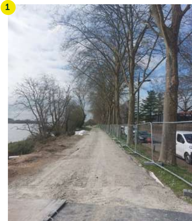
Les travaux consistent à bâtir un mur en blocs de pierre depuis le lit du fleuve jusqu'en haut de la berge. Pour cela il est nécessaire de circuler sur le haut de la berge, le long de l'alignement de platanes. La piste cyclable et le chemin piétons sont protégés par une couche de grave.
